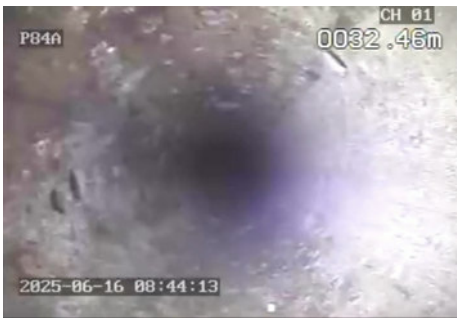
Foto 2. Furo no revestimento
