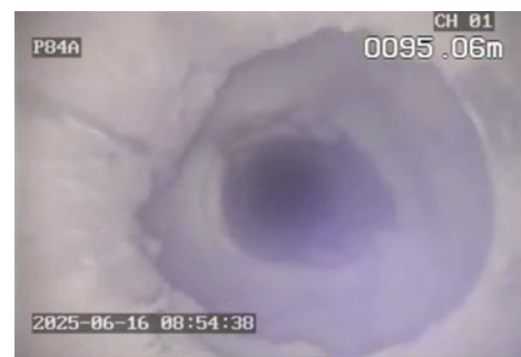
Foto 12. Zona de intensa quebra
