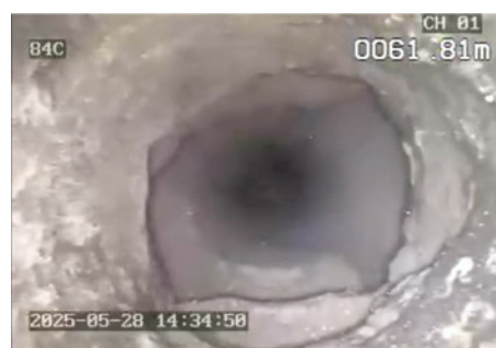
Foto 6. Zona de intensa quebra
