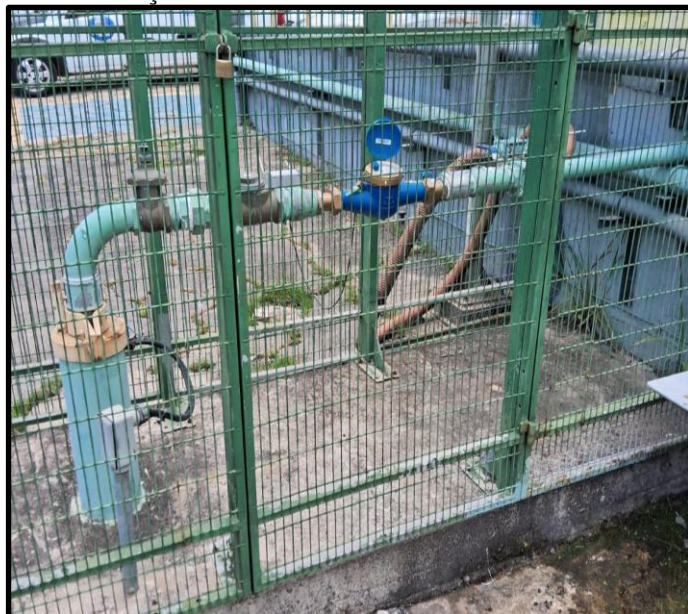
Foto 4 - Poço do Ponto ID IPT 251B.
