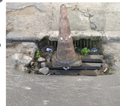
Boca de lobo obstruída no município de Biritiba Mirim
