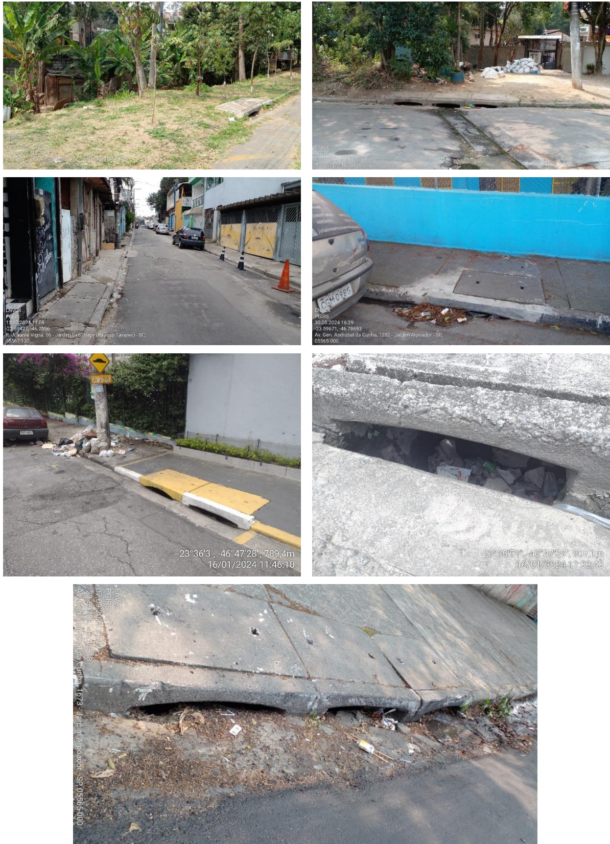
Figura 27: Registros fotográficos da situação de bueiros na sub-bacia do Córrego Jaguaré.
