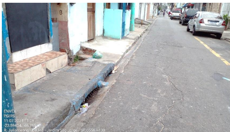
Figura 28: Grades instaladas na abertura do bueiro para impedir a entrada de resíduos sólidos.
