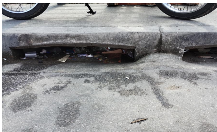
Figura 142: Acúmulo de resíduos em boca de lobo em Jandira.
