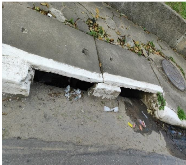
Figura 90: Registro das estruturas de drenagem em Itapecerica da Serra. Fonte: EnvEx Engenharia e Consultoria (2023).
