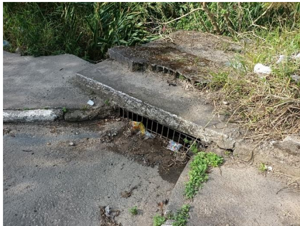
Figura 89: Registro das estruturas de drenagem em Embu-Guaçu. Fonte: EnvEx Engenharia e Consultoria (2023).
