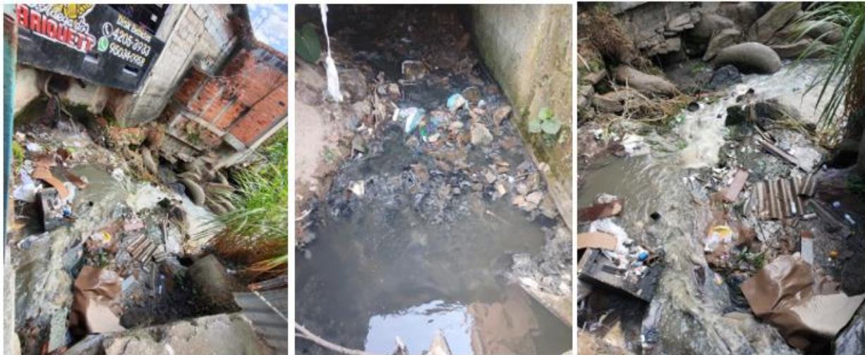
Figura 143: Acúmulo de RCC em corpos hídricos em Jandira. Fonte: EnvEx Engenharia e Consultoria (2023).
