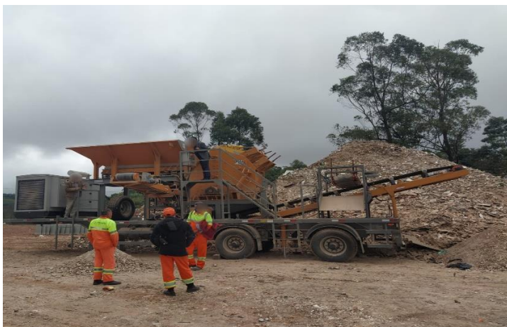
Figura 127: Usina de RCC móvel Grande ABC.
