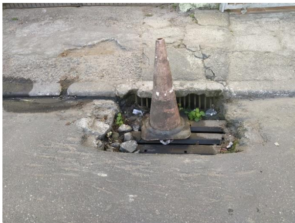
Figura 91: Boca de lobo com sinalização improvisada no município de Biritiba-Mirim. Fonte: EnvEx Engenharia e Consultoria (2023).
