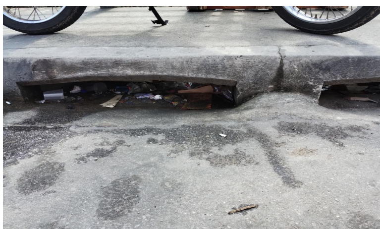
Figura 93: Acúmulo de resíduos em boca de lobo em Jandira. Fonte: EnvEx Engenharia e Consultoria (2023).
