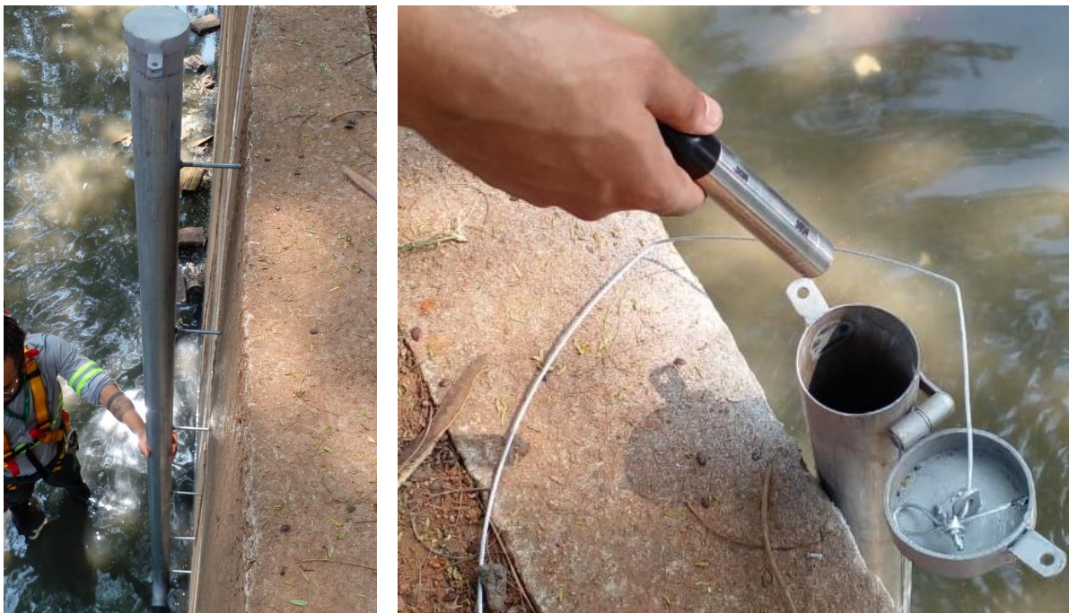
Figura 18: Sonda Onset HOBO Water Level Logger U20-001-01 instalada na estação do córrego Novo Mundo.
